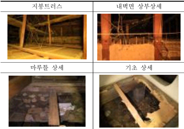
<그림5. 경성전기(주) 마산지점 지붕 및 기초 사진>
