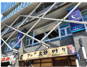
그림1. 상가 유리커튼월 파손 (태풍 마이삭)
